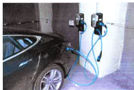
Fig 7 - Bil til Mode 3 lading med løs Type 2 kabel
